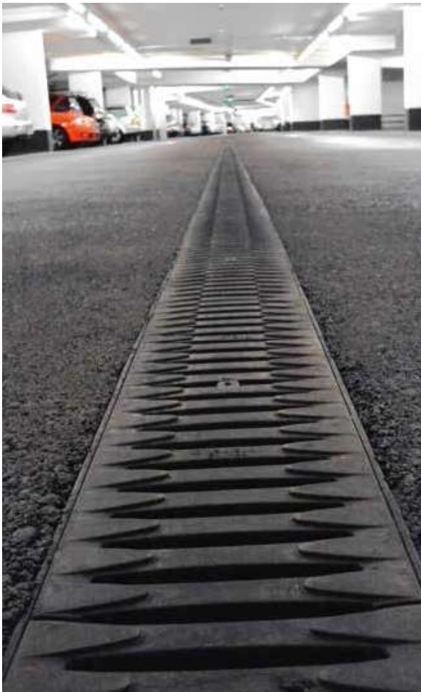
Parking del Grupo Andritz en Viena (Austria)
